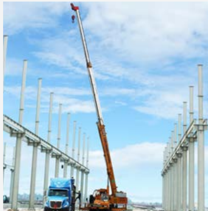
LẮP DỰNG KHUNG NHÀ THÉP CÔNG TRÌNH NHÀ MÁY HOA SEN HÀ NAM
