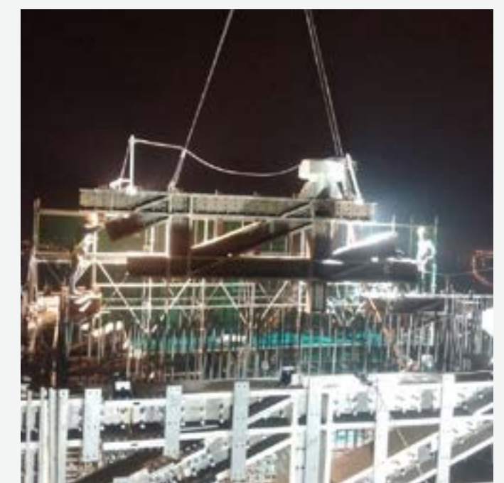
LẮP DỰNG KẾT CẤU LỖI THÉP CÔNG TRÌNH TÒA CAO ỐC LANDMARK 81
