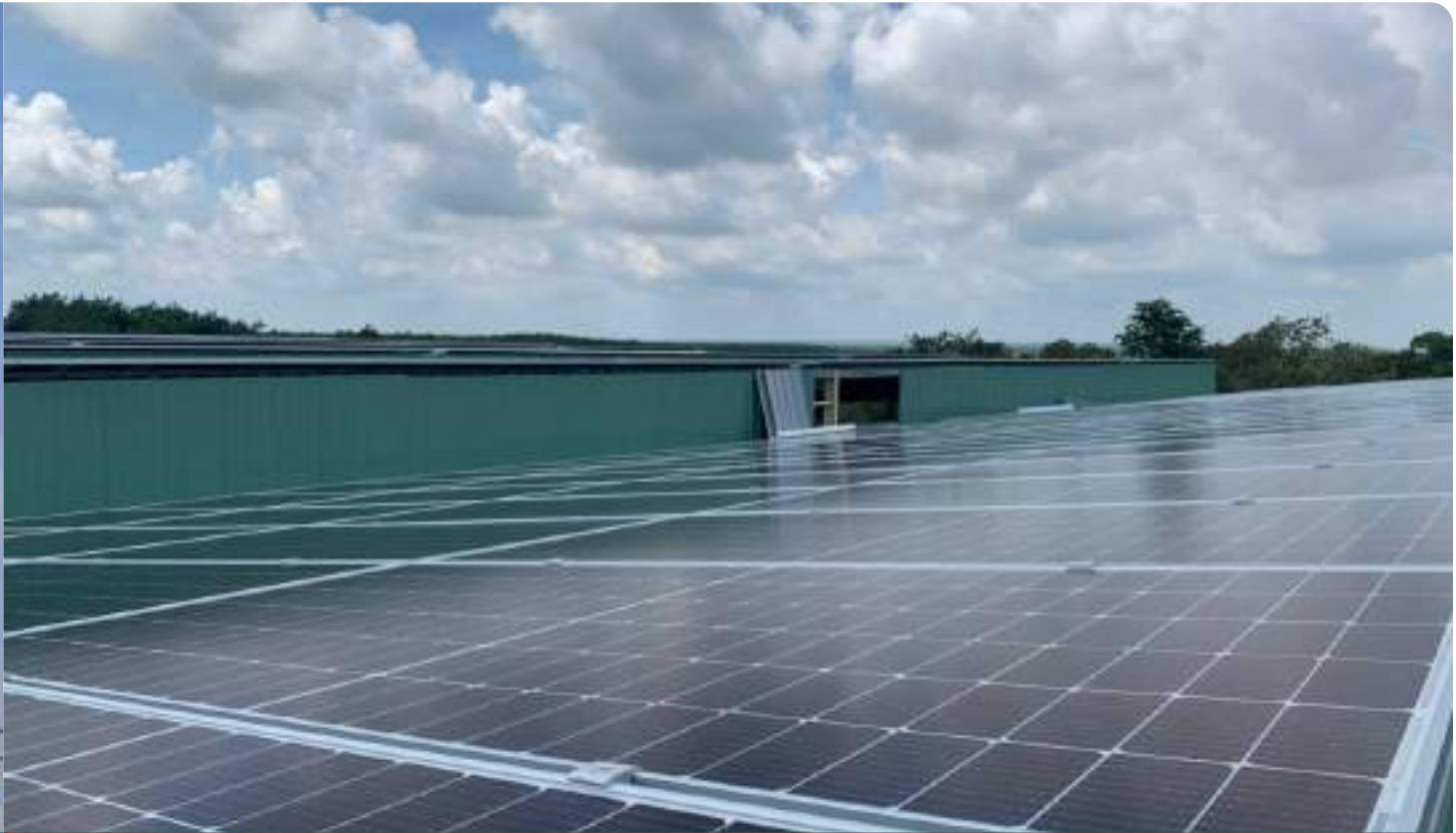
24 DỰ ÁN NĂNG LƯỢNG MẶT TRỜI BÌNH PHƯỚC BINH PHUOC SOLAR ENERGY PROJECT
